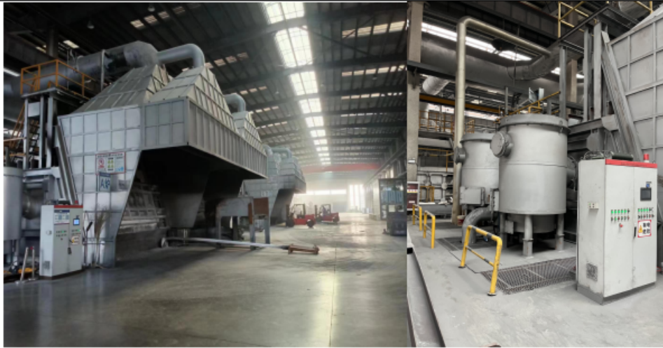
图 3-2 熔炉废气环境集烟及废气处置装置及排气筒
