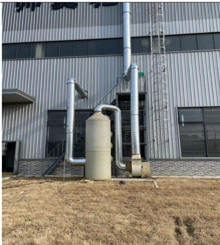
图3-4 危废库废气处理装置
