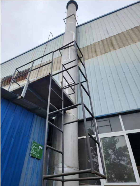
除气设施（DA001）
