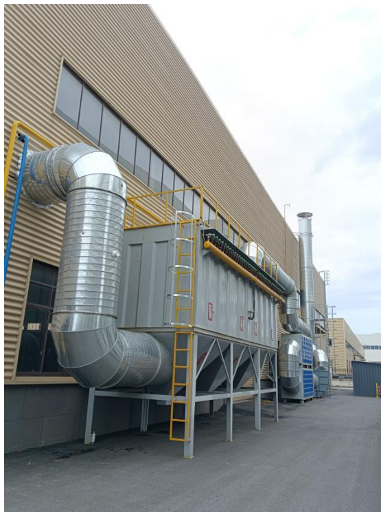
图4-5 浇注、蜡模制造废气排放口（DA003）
