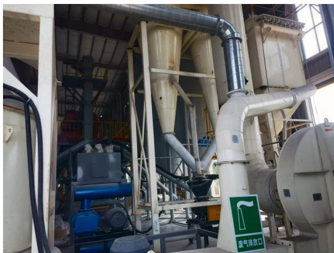
图4-5 钙粉生产线废气排放口（DA002）
