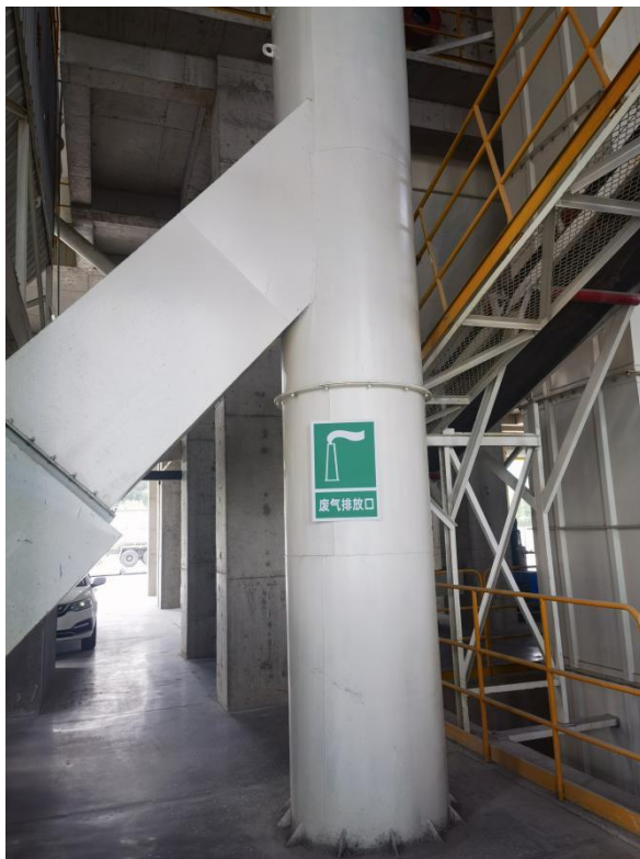
图4-4 干粉砂浆废气排气筒（DA001）
