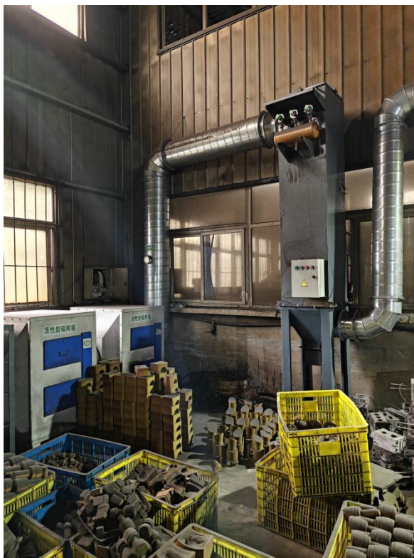
图4-4 制芯废气排放口（DA004）
