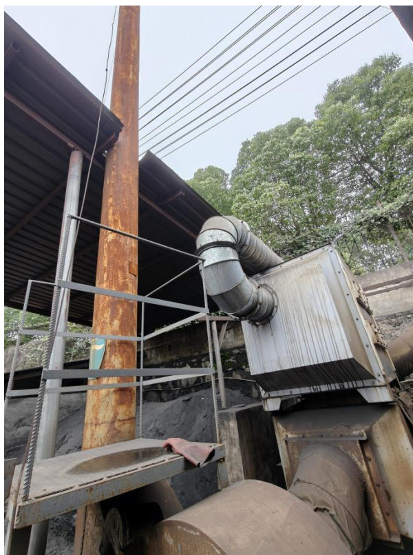
图4-5 浸漆废气排放口（DA005）
