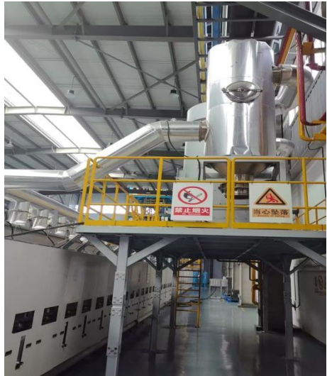
图4-5 聚阴离子正极材料烧结布袋除尘器
