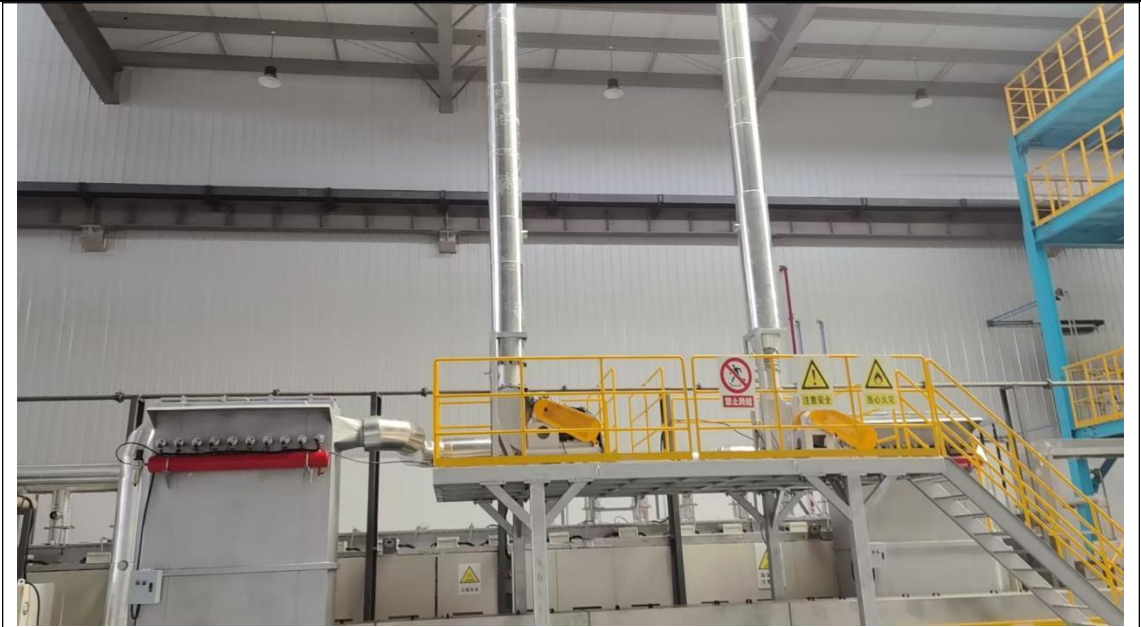
图4-7 层氧正极材料二次烧结布袋除尘器
