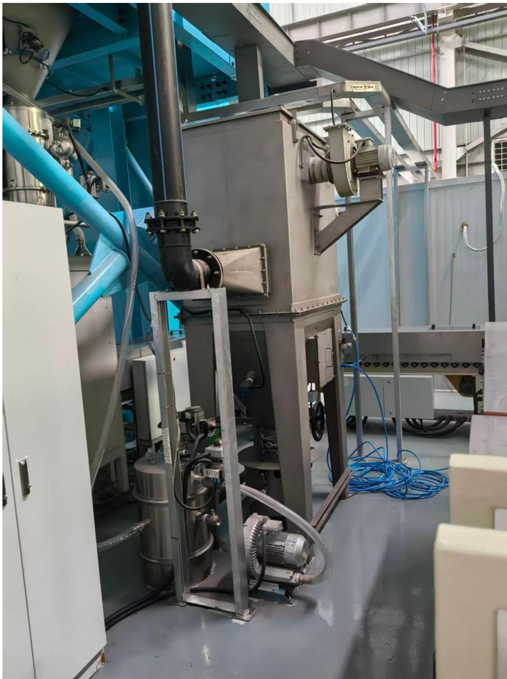
图4-9 层氧正极材料投料工序布袋除尘器
